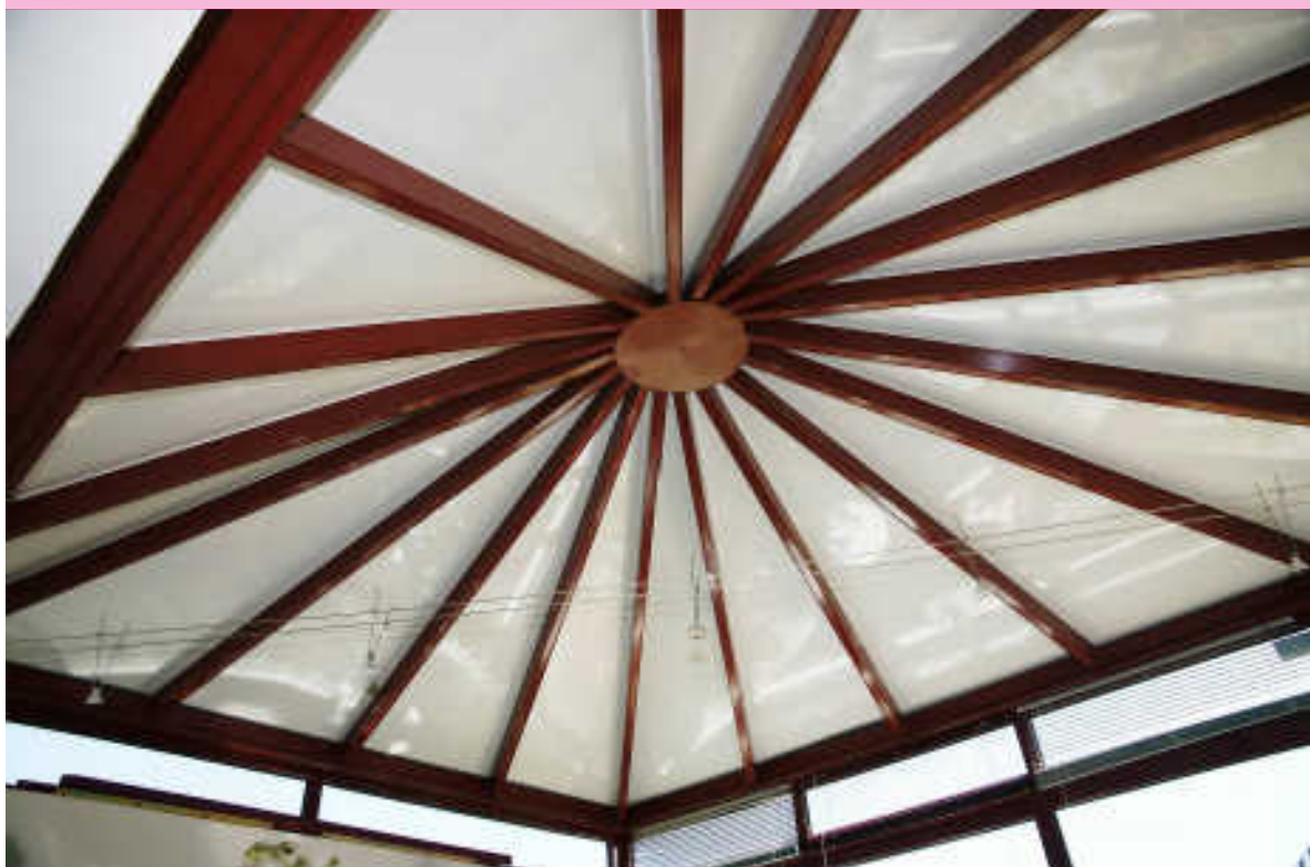
Toiture étoile avec chevrons tubulaires et dôme en aluminium. Remplissage en panneaux sandwich de 85mm d'épaisseur.
